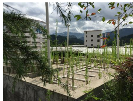
污水处理示范点
